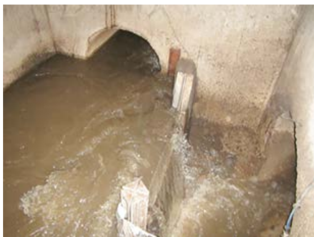
Rejet d'effluents non traités vers le milieu naturel à éviter...
